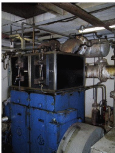
1213 Instalace parního motoru Spilling na pile ve Slavonicích
